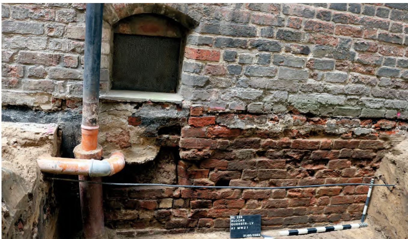
Abb. 6 Blocksquerstraße, die neu eingebaute Fensteröffnung wurde wegen der Erhöhung des Straßenniveaus abermals um 65 cm nach oben versetzt.
