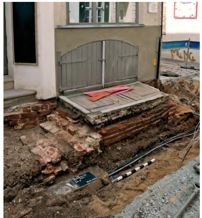
Abb. 1 Mengstraße 31, intakter Kellerabgang mit abgebrochenen älteren Treppenwangen zu beiden Seiten, nachträglich verkleinert und erhöht. Links daneben: Streifenfundament einer älteren Treppenanlage zum Erdgeschoss.
